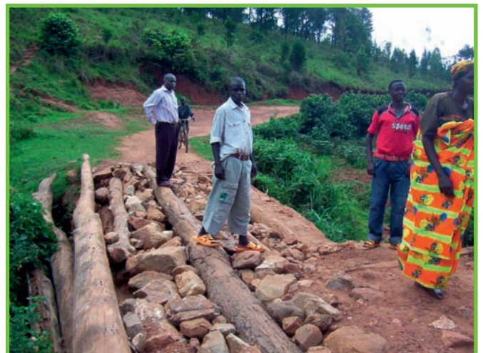
Ponte pericolante nel comune di Marangara
