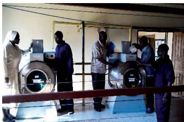
Installazione delle lavatrici
