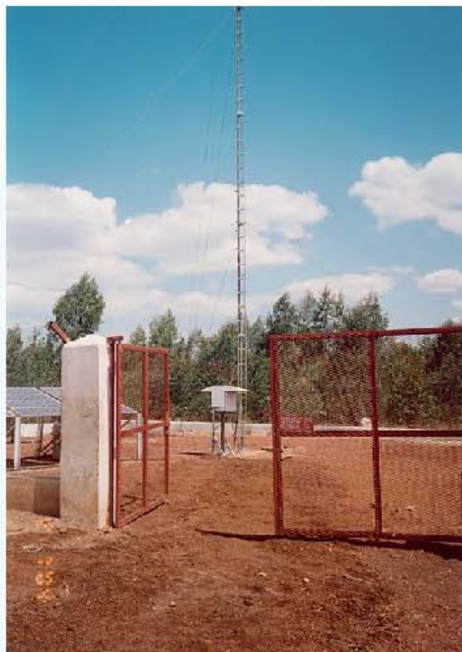
Veduta dell'antenna satellitare
